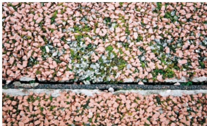
A défaut d'entretien régulier, voilà ce qui se passe...
